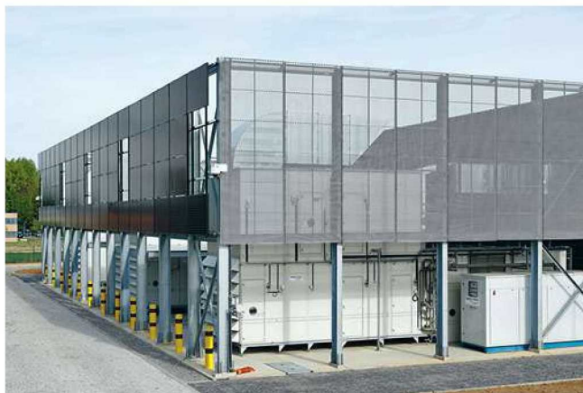
Het tweede datacenter van Sopra Steria vond onderdak bij Engie Cofely in Gembloux.
